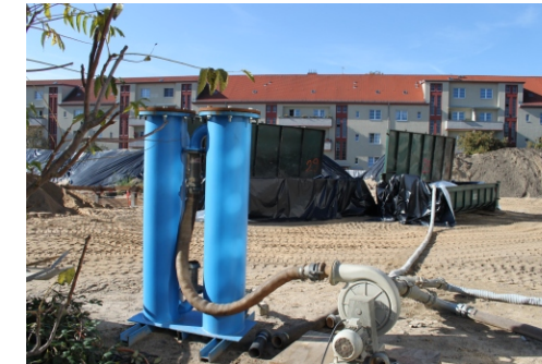
▲ Entwässerungscontainer (oben) und Abluftreinigungsanlage (unten)
